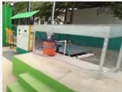
Figura 2.3. Área de trituración de residuos y de mezcla con agua para formación de lodo
