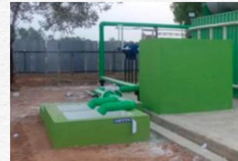
Figura 2.12. Depósitos de almacenamiento del digestato
