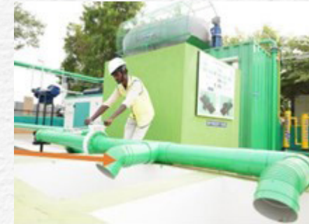
Figura 2.11. Sistema de salida del digestato
