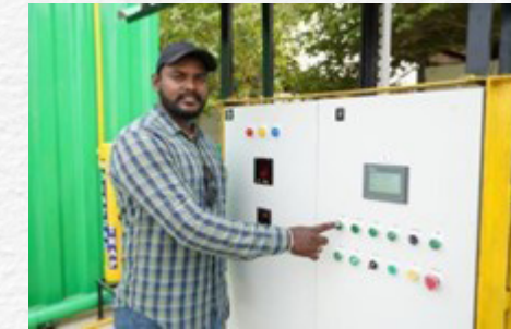
Figura 2.5. Unidad de control central de la planta de biogás
