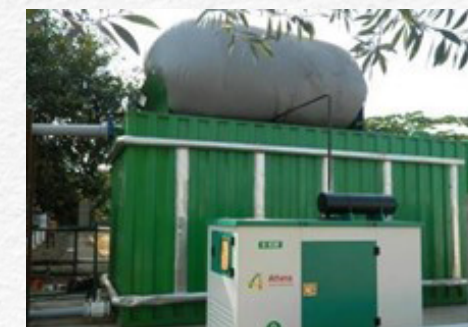
Figura 2.6. Biodigestor para el procesamiento de 1,5 toneladas de residuos orgánicos por día
