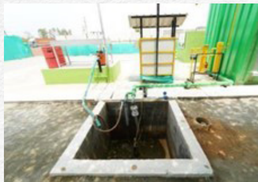
Figura 2.4. Tanque de almacenamiento de lodo
